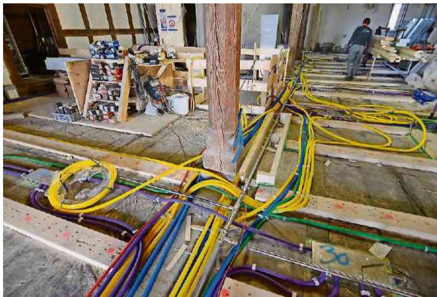
Sämtliche technische Infrastruktur wird in die Böden verlegt. FOTOS: HANSJÖRG SAHLI
